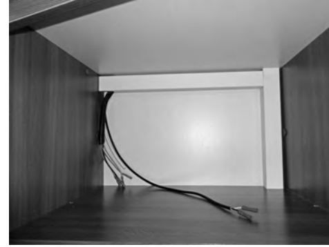
Antenne und Sat-Kabel
