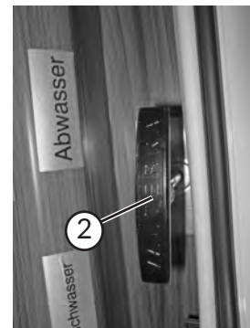
Schieber für Abwasserauslass
