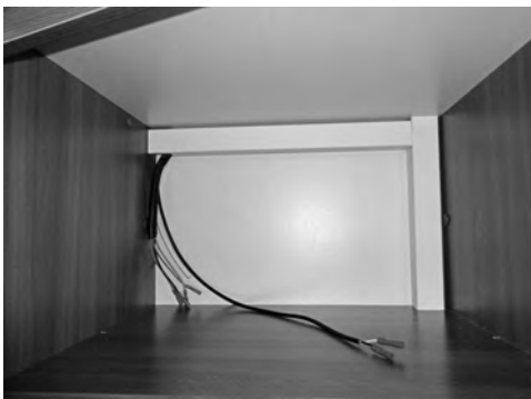
Antenne und Sat-Kabel
