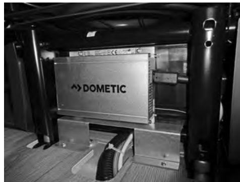
Fahrzeugelektrik unter dem rechten Vordersitz
