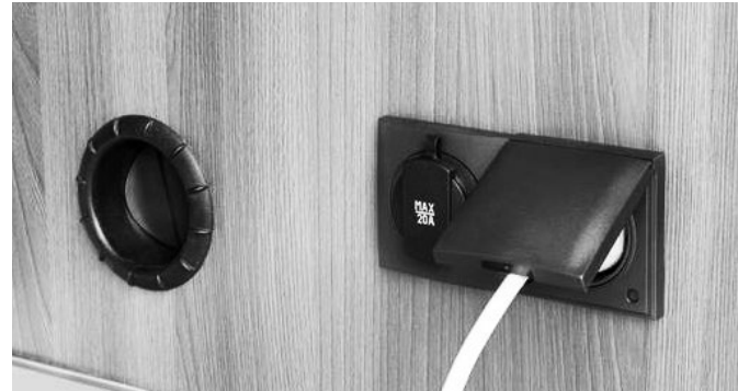
Steckdosen im Innenraum
