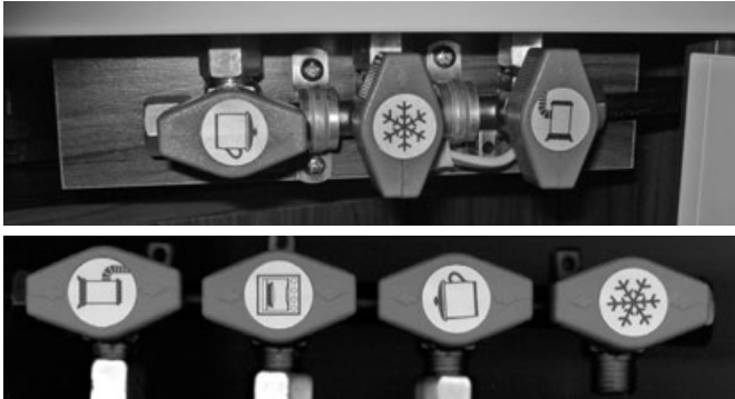
Heizung (Backofen*) Gaskocher Kühlschrank
