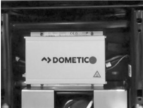
Fahrzeugelektrik unter dem rechten Vordersitz
