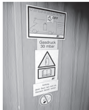
Indicaciones de seguridad en la caja para botellas de gas
