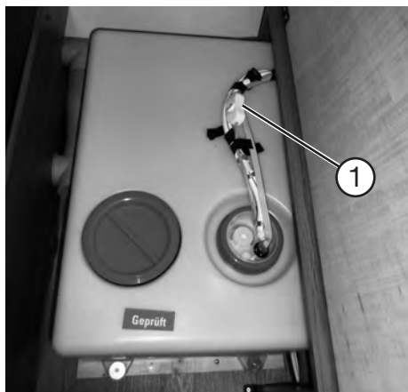
Brytare för vattenpumpen
