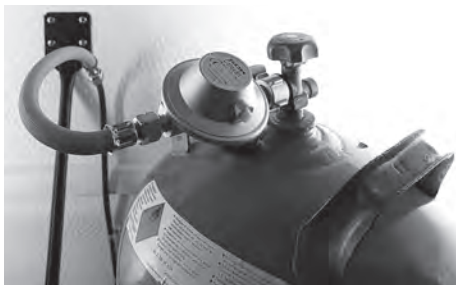
Gasregulatorns anslutning till gasflaskan
