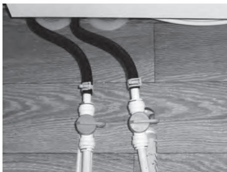
Ventiler i stängd position
