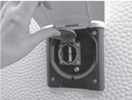
Förtälts-utomhusuttag med antennanslutning
