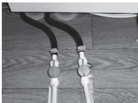
Ventiler i öppen position
