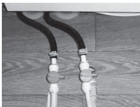
Ventiler i stängd position
